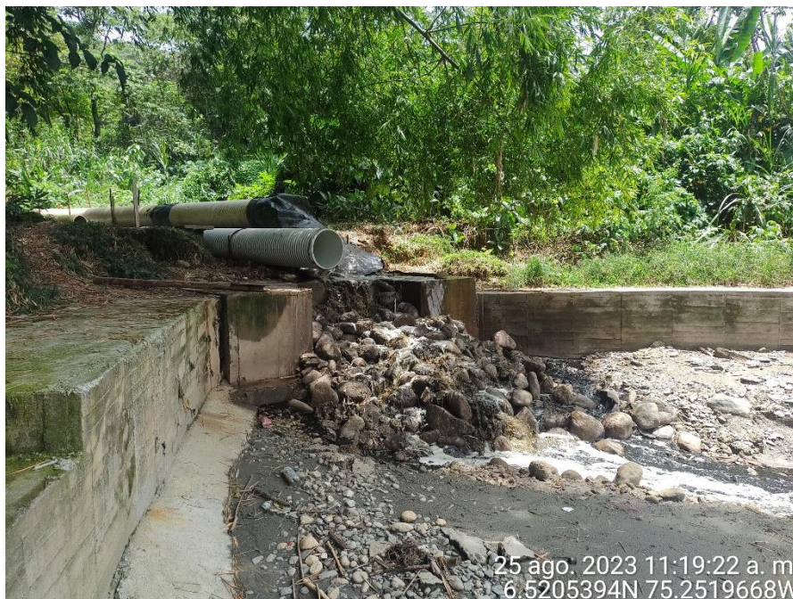
Fotografía 25. Estado del vertimiento de lixiviados (25/08/2023).
