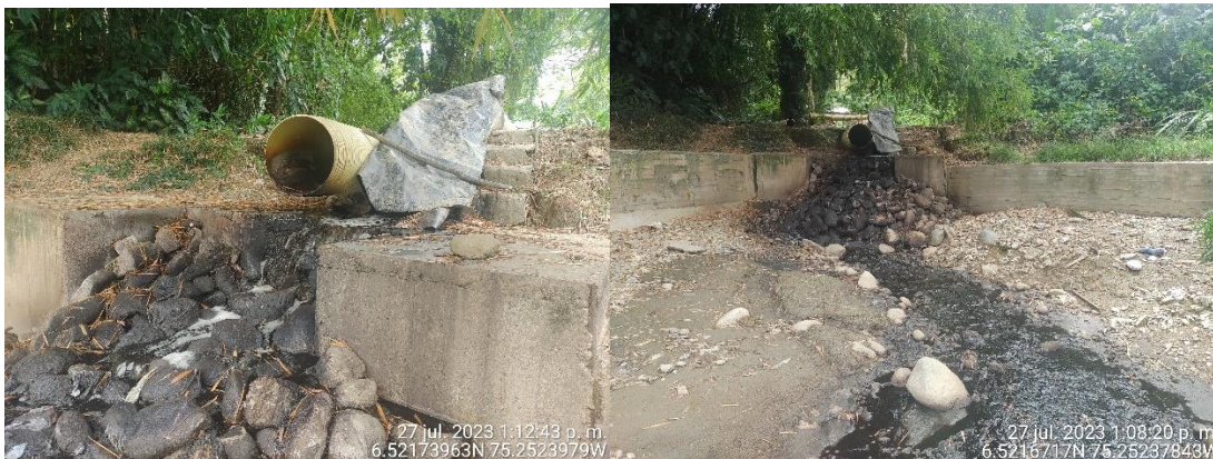
Fotografía 14. Estado del vertimiento de lixiviados.
