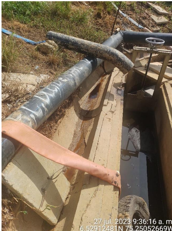
Fotografía 7. Canal de recolección, regulación y transporte de lixiviados generados en el vaso Altair. Obsérvese que la compuerta bloquea el paso hacía la planta de tratamiento. Los caudales son dirigidos hacia las piscinas de Altair.
