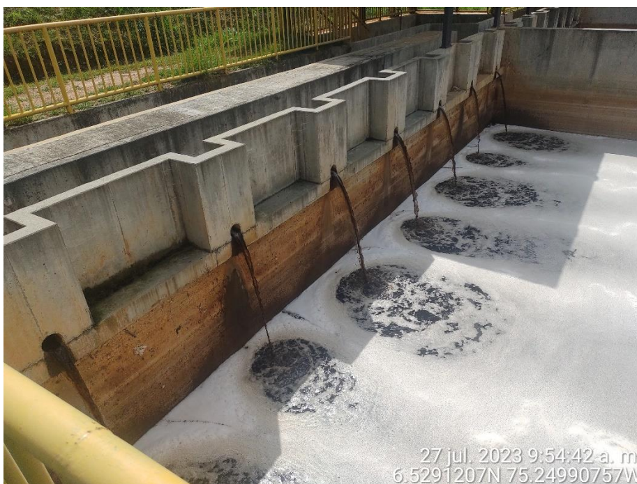
Fotografía 8. Almacenamiento de lixiviados en las piscinas del vaso Altair.
