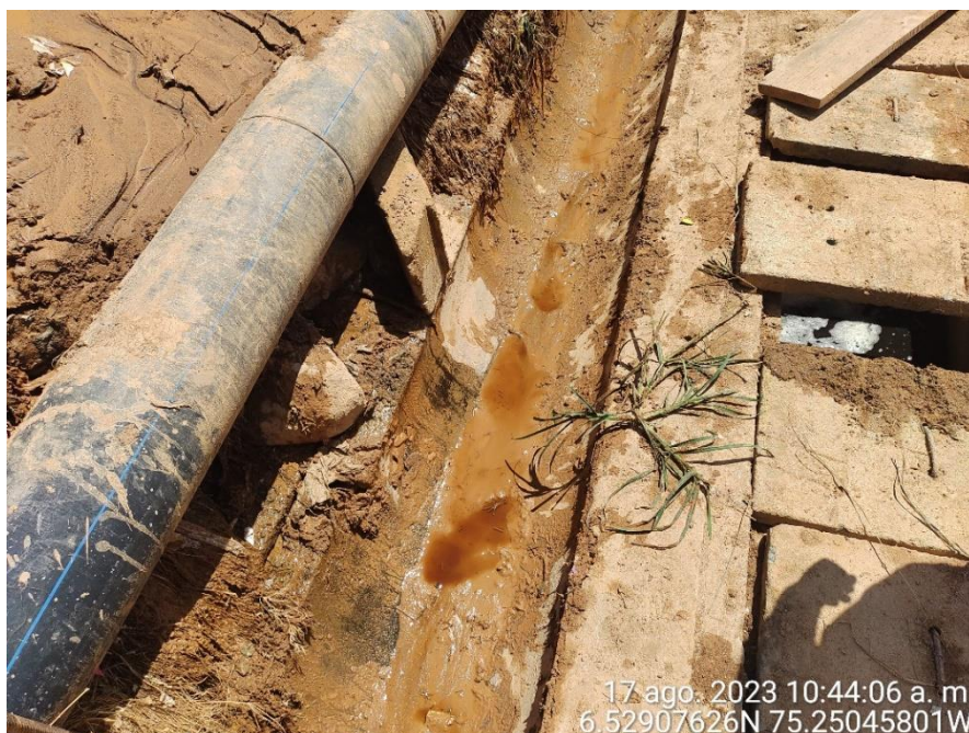
Fotografía 16. Lixiviados sobre la superficie de la sección expuesta del dique sur. Berma 1084 msnm.
